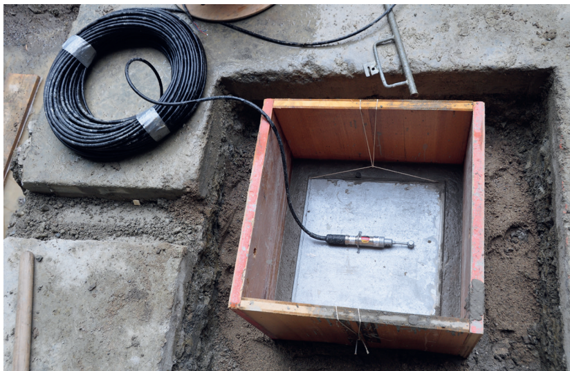
Eine von mehreren Sohldruckgebern zur Messung der Bodenpressung als langjähriges Überwachungsinstrument der KPP-Fundation.
