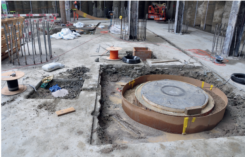
Eine von mehreren Pfahlkraftmessdosen als Teil des langjährigen Monitorings der KPP-Fundation.
